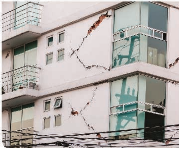
Figura 3.8 Daño por sismo en una construcción de mampostería no reforzada, es decir, sin castillos en la esquina.
